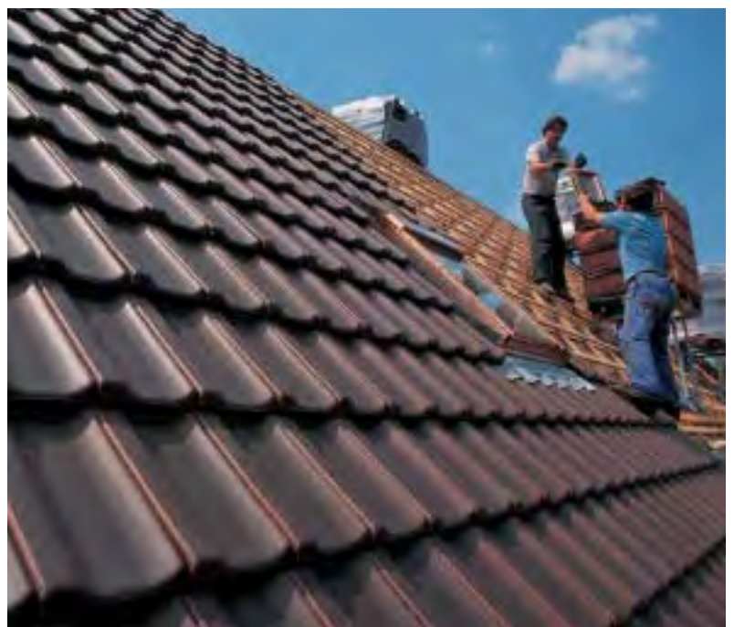
Die handwerkliche Arbeit ist entscheidend für die Qualität von Dachkonstruktion und Deckung
