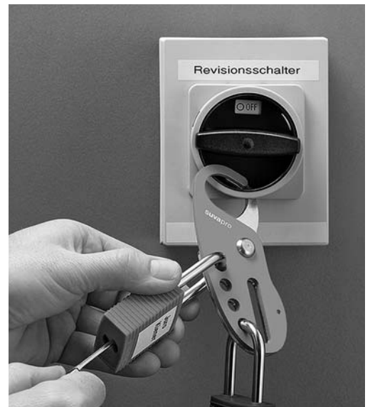
Bild 1: Gesicherter Revisionschalter mit Vorhängeschloss und Mehrfach-Schliessbügel
